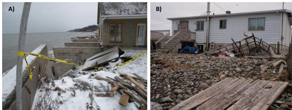
FIGURE 28. DOMMAGES OBSERVÉS AUX STRUCTURE DE PROTECTION SUITE AU PASSAGE DE LA TEMPÊTE DU 6 DÉCEMBRE 2010.
