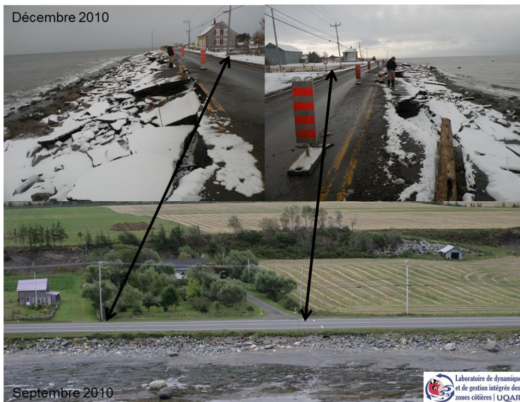
Figure 12. Haut : route 132 à Sainte-Flavie après la tempête du 6 décembre 2010. Bas : Route 132 en septembre 2010 avec la présence d'un enrochement et d'un muret de bois (© LDGIZC-UQAR)
